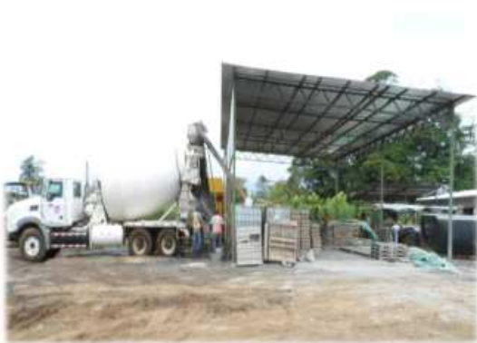
PLANTA DE CONCRETO
