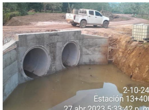
Evacuación Pluvial, Chorreras, Cutris
