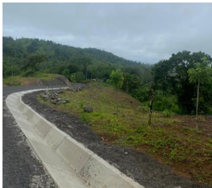
Evacuación Pluvial, Montelimar, Monterrey
