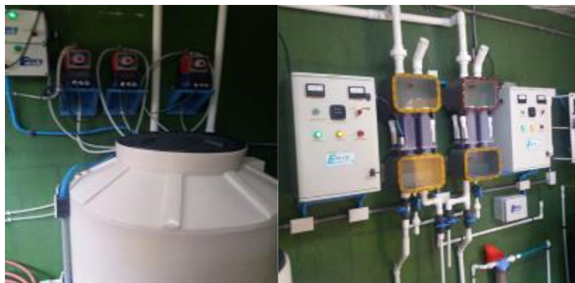
Ilustración 31. Cloración y Desinfección
